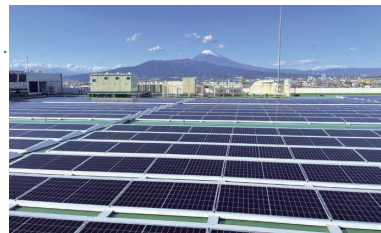
三島工場 太陽光発電設備
