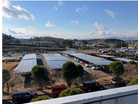
今回導入した PPA モデルの太陽光パネル
