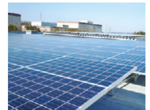
滋賀工場の太陽光パネル
