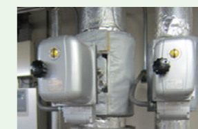
蒸気の供給を自動制御するバルブ
